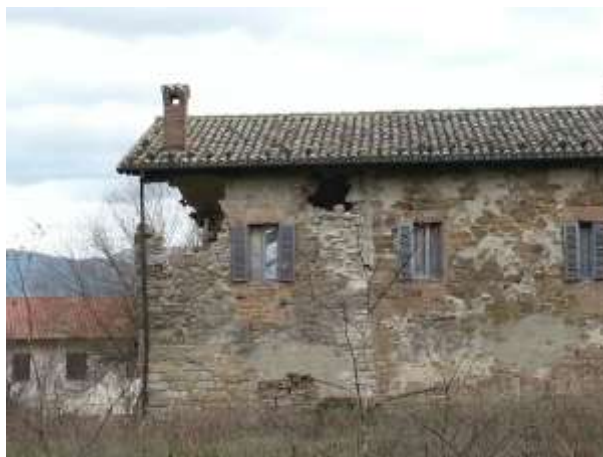
Fig. 2 – Edificio a Camerino danneggiato dalla sequenza sismica iniziata il 24 agosto 2016
