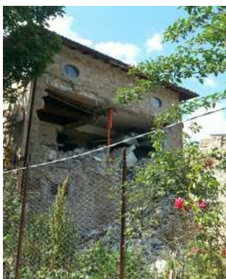
Fig. 3 – Edificio a Grisciano danneggiato dalla sequenza sismica iniziata il 24 agosto 2016
