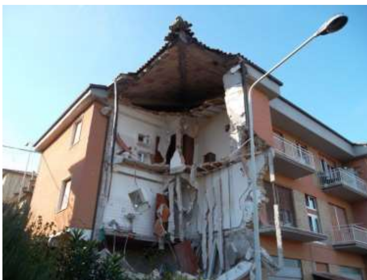
Fig. 4 – Edificio a San Severino Marche danneggiato dalla sequenza sismica iniziata il 24 agosto 2016
